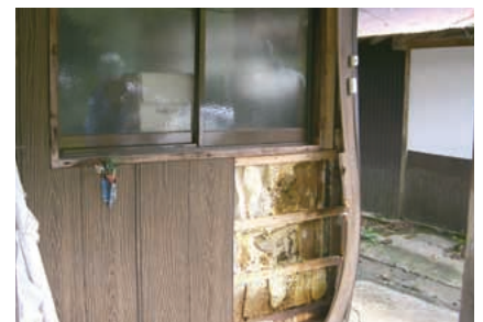
壁の中の蜂の巣を狙って壊された民家の壁
