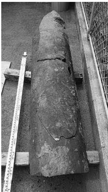
破損した配水管
