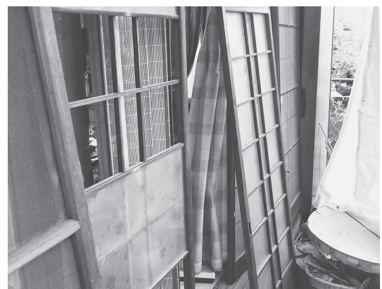
爆風により破壊された窓（南栄3丁目）
