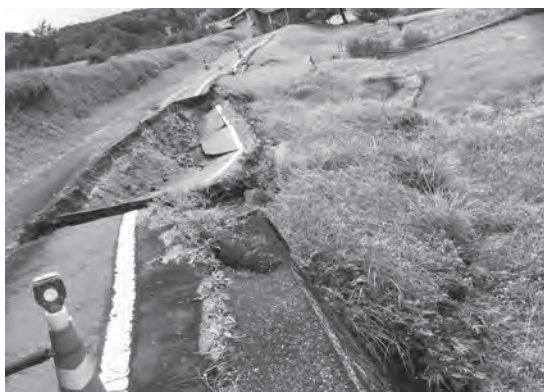
道路が陥没し、土砂が農水路を塞ぐ
