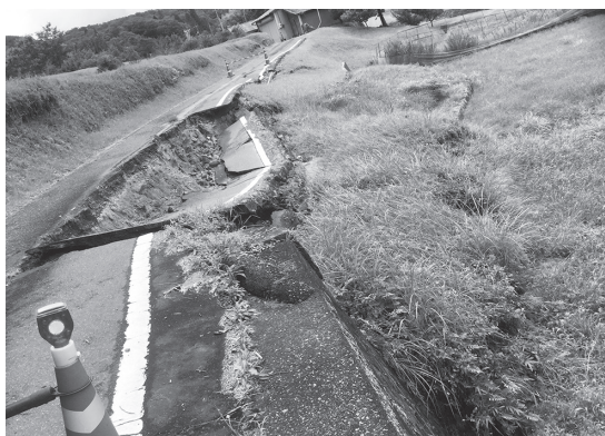
道路が陥没し、土砂が農水路を塞ぐ
