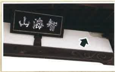
▲本堂梁を支える「肘木」破損の跡
