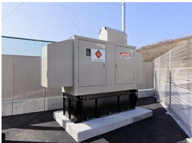
自家発電設備
