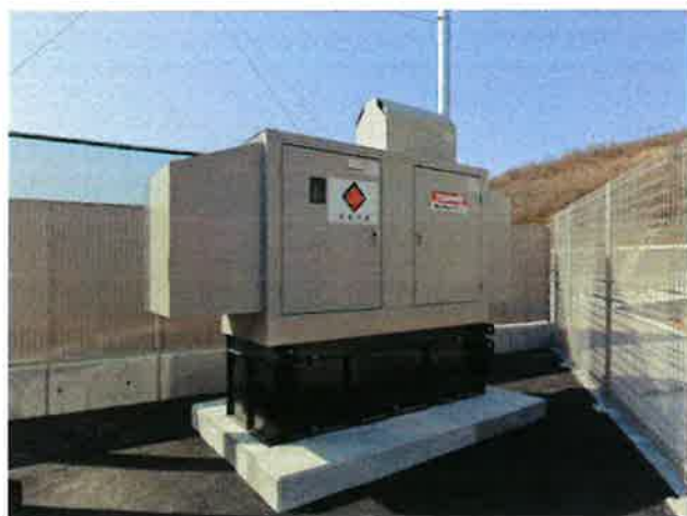
自家発電設備
