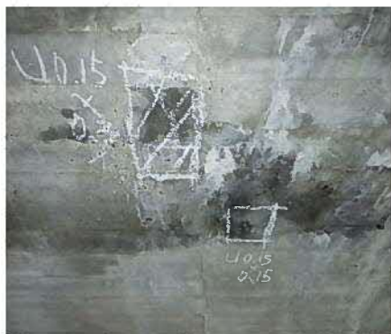
覆工・坑門のうき・はく離
