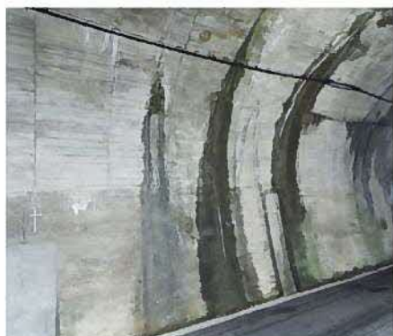
覆工・坑門の漏水
