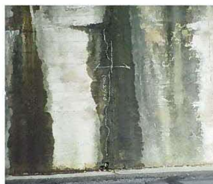
覆工・坑門のひび割れ
