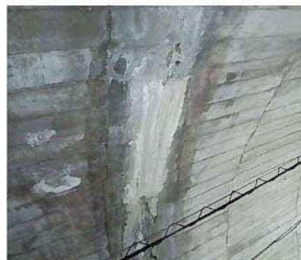
覆工・坑門の材質劣化
