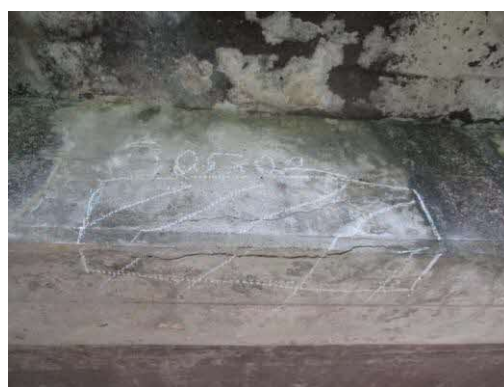
コンクリートの浮き 小栗林3号線1号橋
