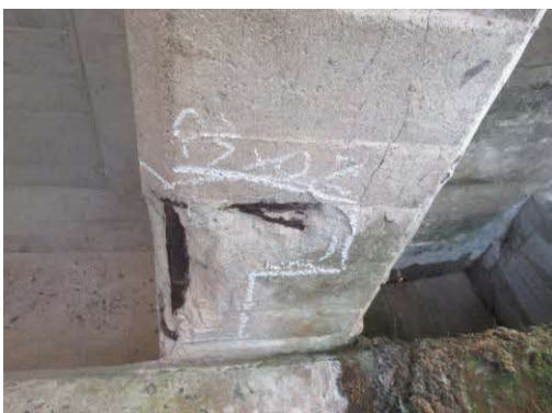
主桁の鉄筋露出 無名橋
