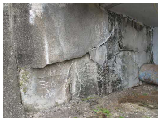
コンクリート橋台のひび割れ・剥離・浮き 恵川橋
