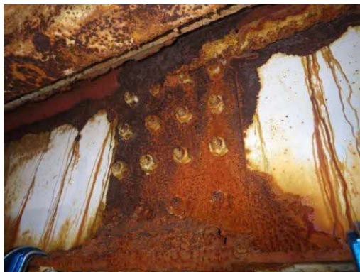
主桁の腐食 城山陸橋
