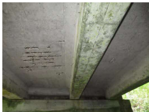
コンクリート床版の鉄筋露出 谷尻橋
