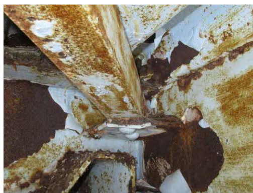
横桁の腐食 向田橋（歩道）
