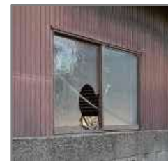
窓が割れた管理不全空家
