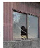
窓が割れた 管理不全空家
