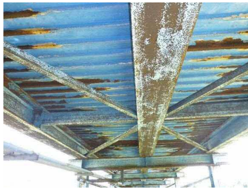
鋼床版の腐食・欠損
