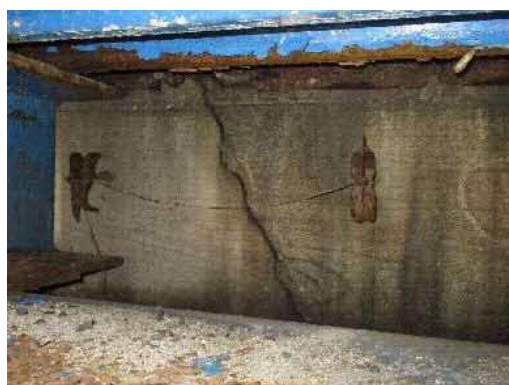
橋台のひび割れ・鉄筋露出
