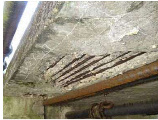
コンクリート床版の鉄筋露出・腐食
