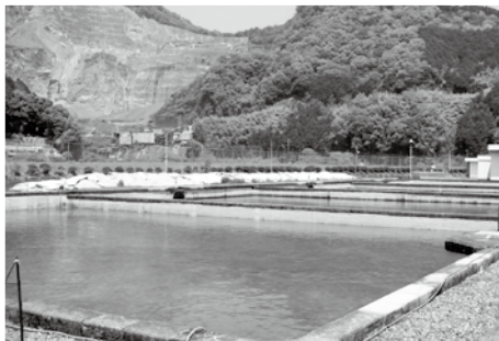
4つの緩速ろ過池がある防鹿浄水場。
