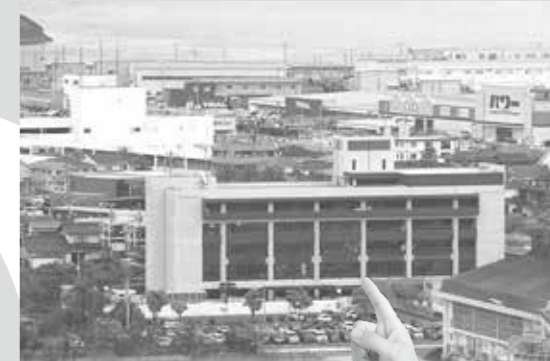
現在、耐震改修工事中の市役所。工事のため事務室が移動し、ご不便をおかけしています。
