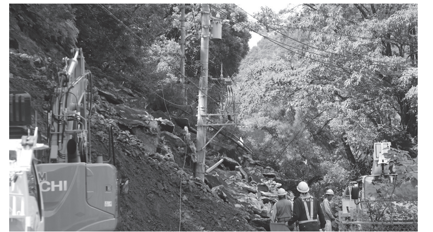
平成30年7月豪雨で斜面が崩落。御園1丁目地内の市道をふさいだ。
