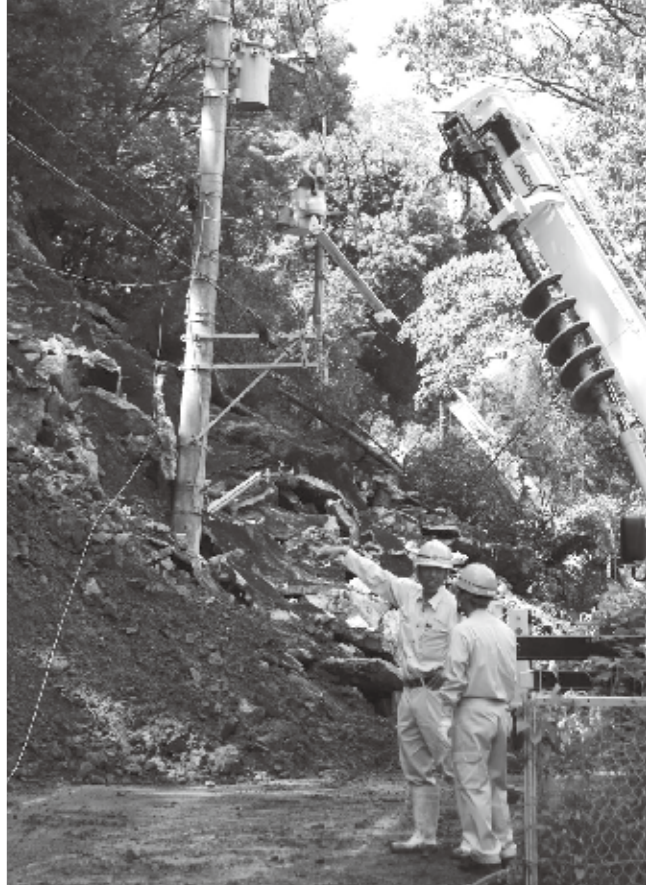
御園台下の市道で発生した土砂崩れ。(7月10日撮影)
