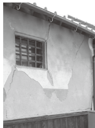
芸予地震で剥がれ落ちた壁
