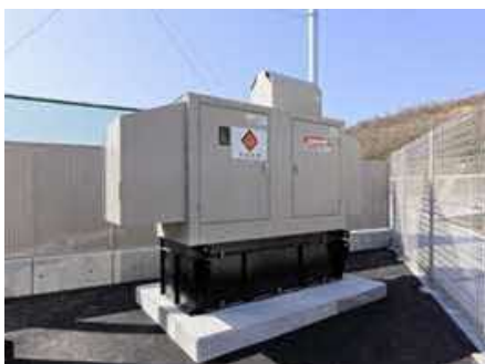
自家発電設備
