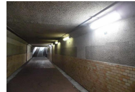
②対策後(地下道外灯)
