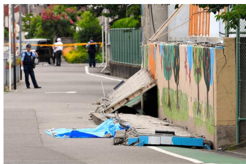
▲大阪府北部地震時のブロック塀の倒壊（朝日新聞より）
