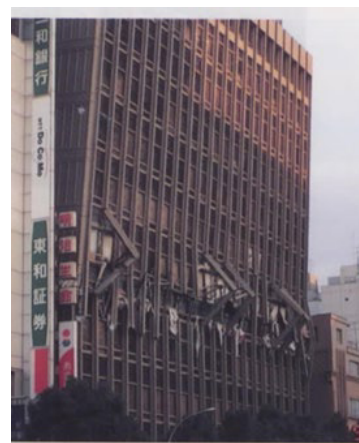
▲阪神・淡路大震災による外壁・窓ガラスの破損
