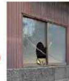
窓が割れた管理不全空家
