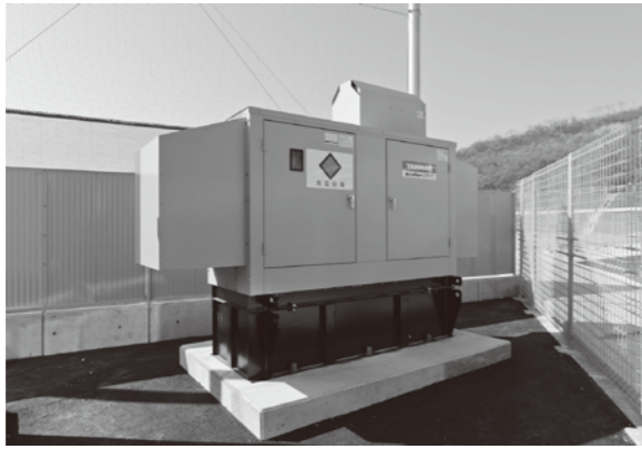
災害に備えて自家発電機を設置
